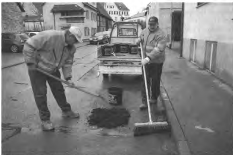
Harter Winter führt zu großen Straßenschäden
